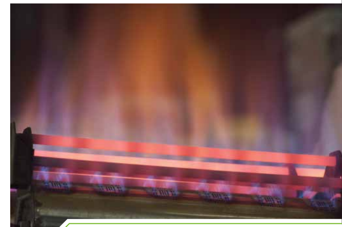
Flammenbild eines Heizungs Brenners
