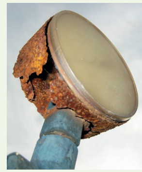
Korrosion am Manometer der Gasstrecke
