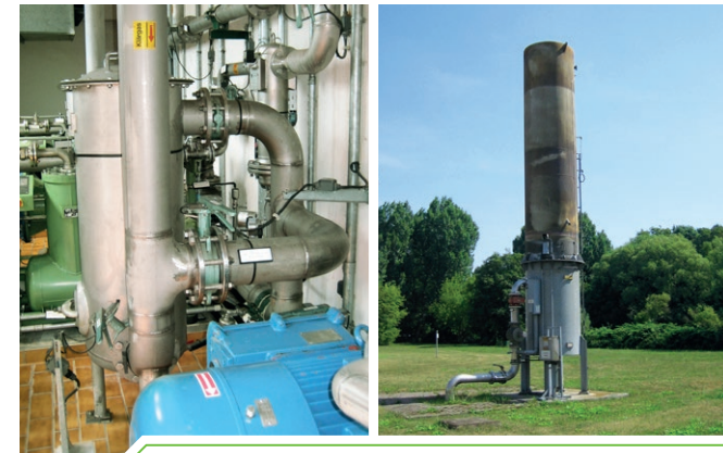
Typische Anlagentechnik einer Gasstrecke
