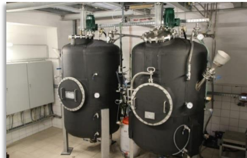
Kleintechnische 2 m 3 - Biogasversuchsanlage am DBI - Gastecnologisches Institut gGmbH Freiberg (©DBI)
